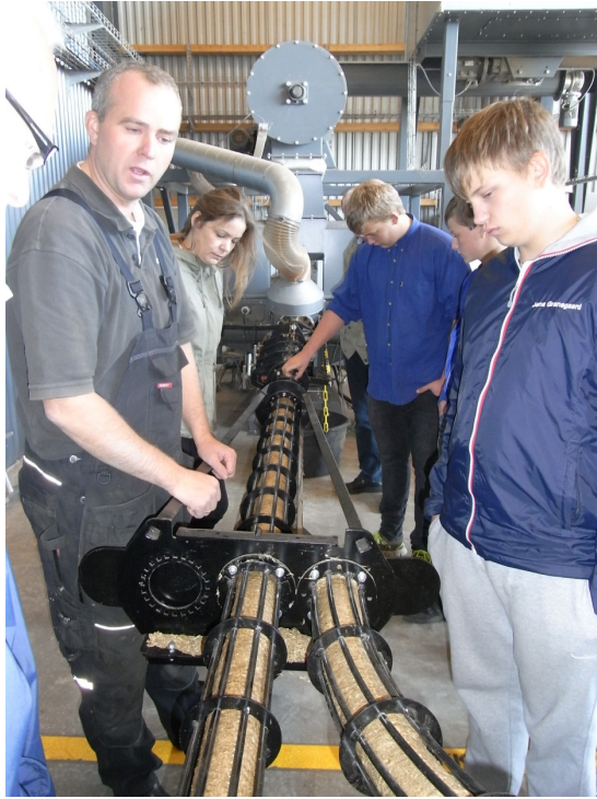
Den pelletterede halm på vej til biogastanken
